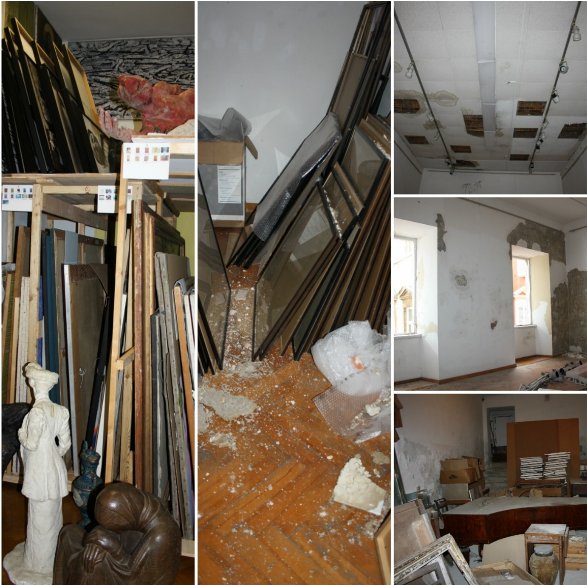
Slika 13: Primjeri lošeg stanja prostora pojedinih odjela NMZ i depoa
